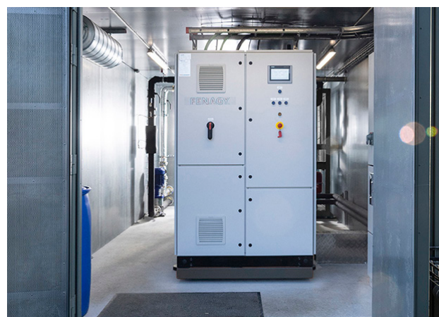
Varmpumpen er installeret i et fuldt udstyret maskinhus ved siden af gartneriet.
