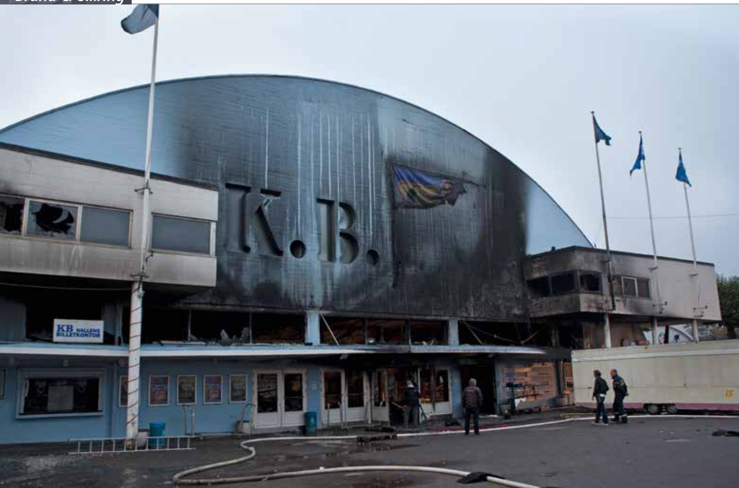
KB Hallen brændte i 2011, da ABA-anlægget var slået fra i forbindelse med en messe.
