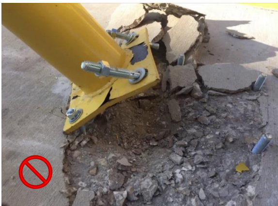
Store skader i belægningen og en pullert, som er sat ud af drift.
