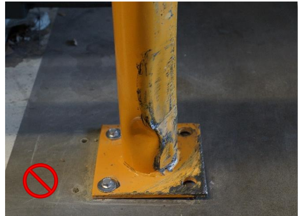
En enkelt påkørsel mere og pullerten kan kasseres. Måske den også ødelægger belægningen.
