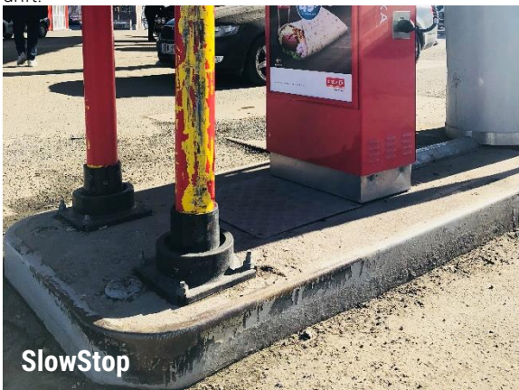
Trods flere påkørsler er der ikke sket skade på fundamentet med pullerter fra SlowStop
